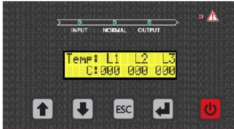
) Trafo Sıcaklık Bilgisi(L1,L2,L3)
